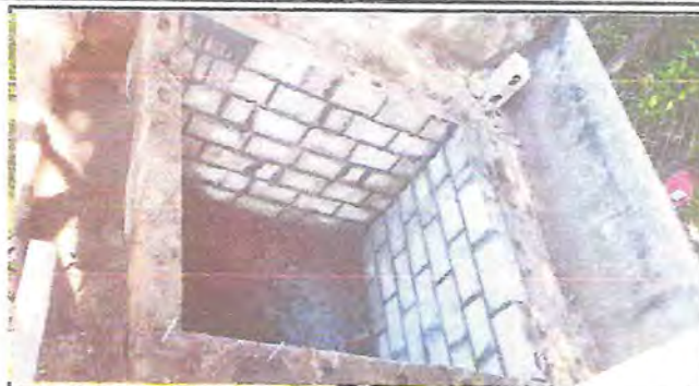
Foto 8: fosa para baños
